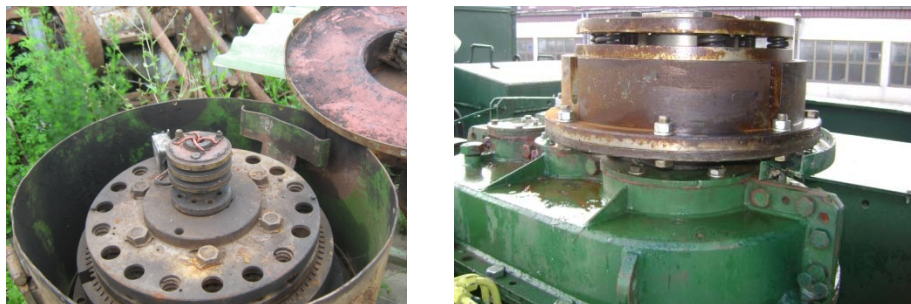
Slika 3: Stara lamelna spojnica sa kuplungom i krajnjim prekidačima, lijevo-lamelna klizna spojnica ugrađena na reduktor zakretanja GGB
